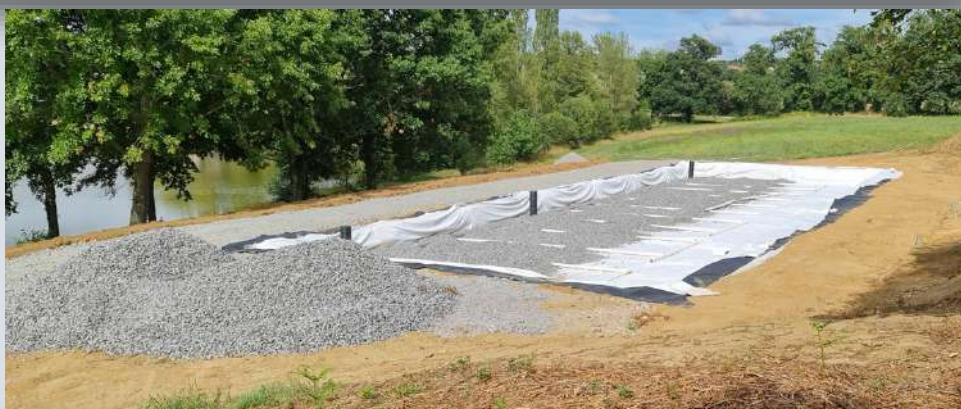
Filtre 1er étage—3 casiers de 121 m 2
