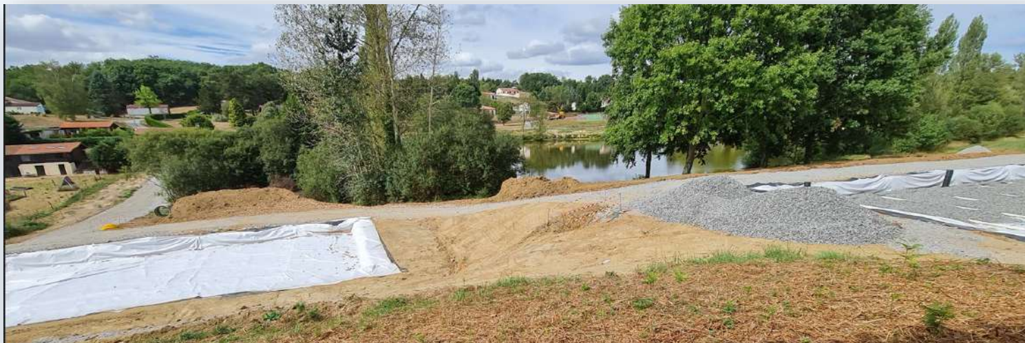
Vue d'ensemble des deux filtres
