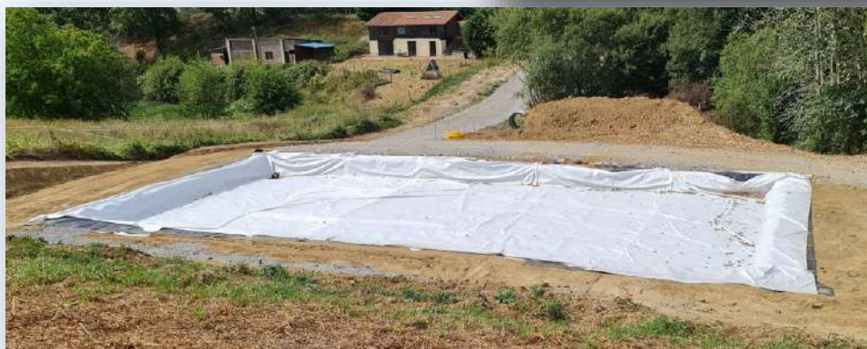
Filtre 2ème étage—2 casiers de 121 m 2
